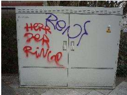
Power/distribution box (Item: HeRR DeR RiNGe)
